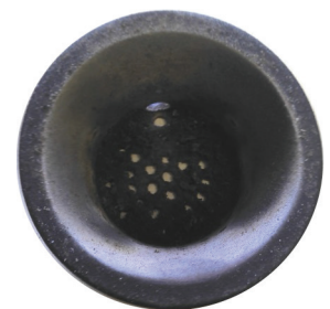
Fig. 14 Brännkopp med hålen täppta av aska. Rengöring är nödvändig.
