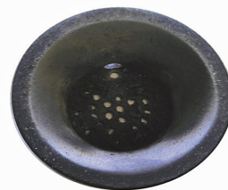
Fig. 14 Brännkopp med hålen täppta av aska. Rengöring är nödvändig.
